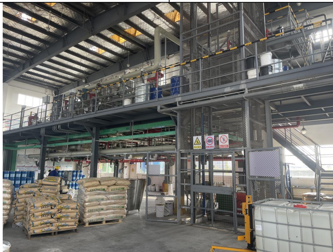
生产车间四管线布设情况以及生产情况
