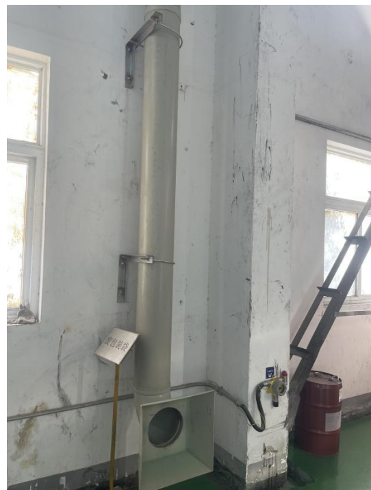
危废仓库废气收集装置建设情况
