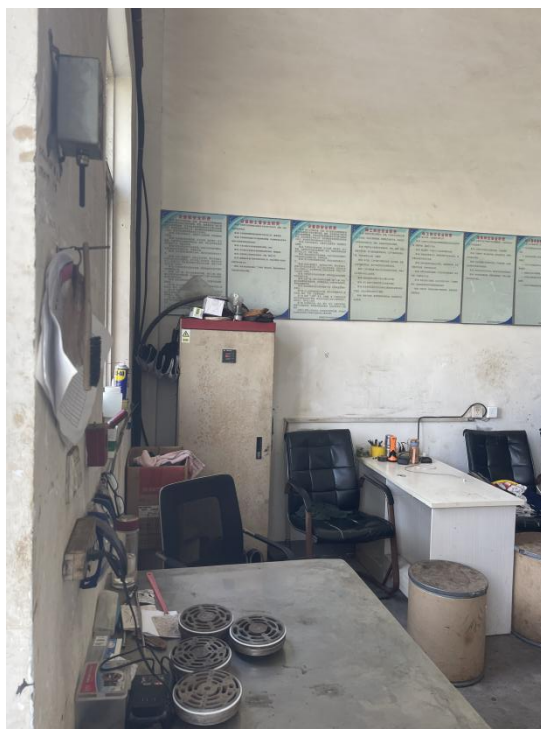
机修车间墙面情况
